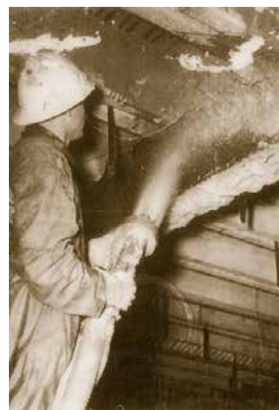
Un operatore che spruzza fibre di amianto senza nessuna protezione, le norme erano carenti...
